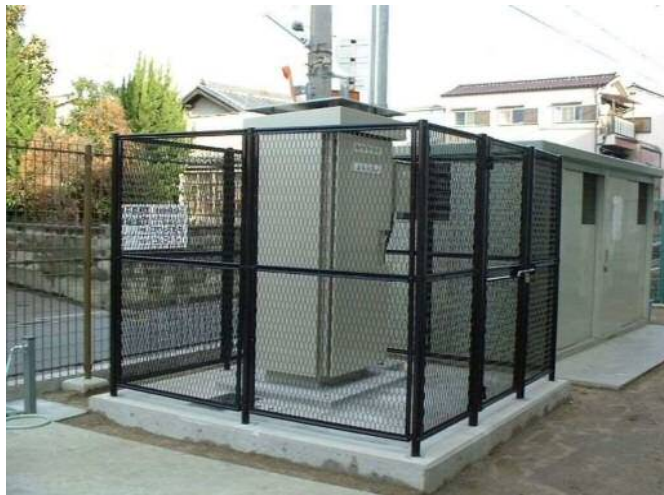
自動水質監視装置（水質モニター） 楠根中学校内
