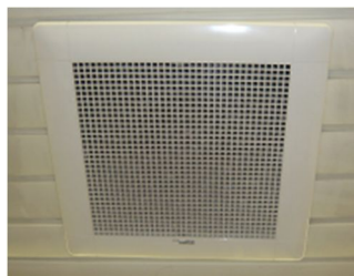
エアコンや給気口の目詰まり
