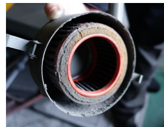
給気口フィルタの目詰まりの例
