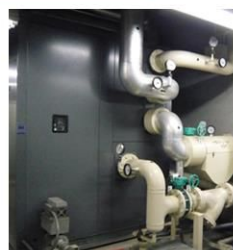
吸収式冷温水機
