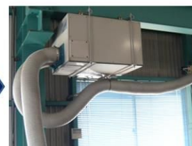
スポット式エアコン
