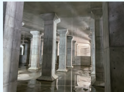
布施公園の地下空間にある調節池
